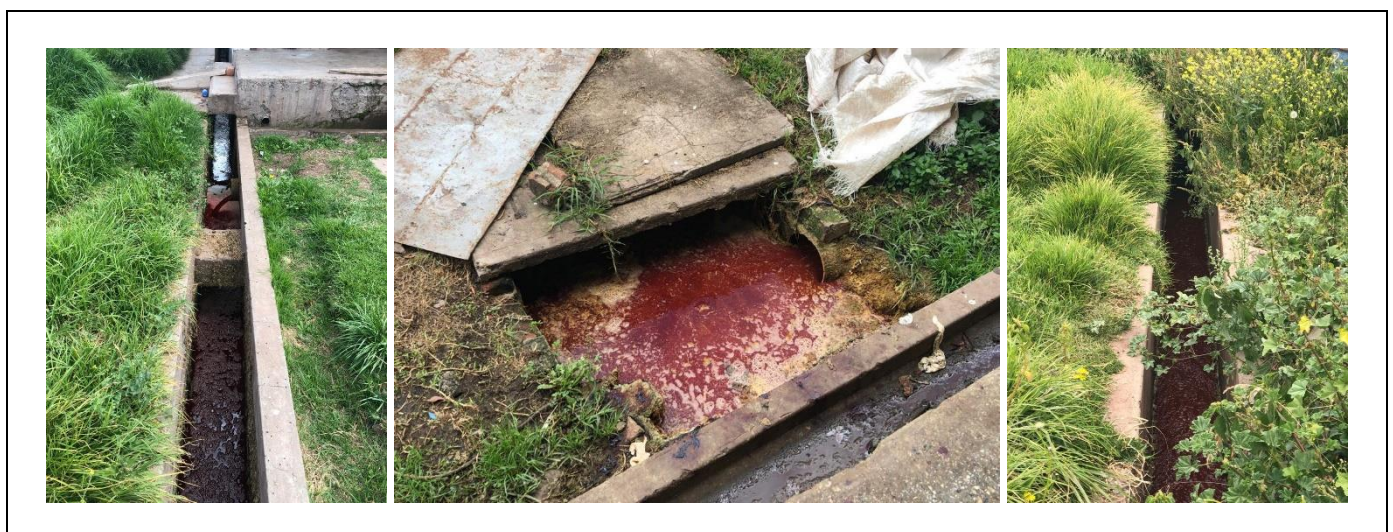
Figura 69: Canales de evacuación de aguas residuales
