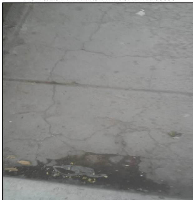
FIGURA 1 RAJADURAS EN VEREDAS EN LA CIUDAD DEL CUSCO
