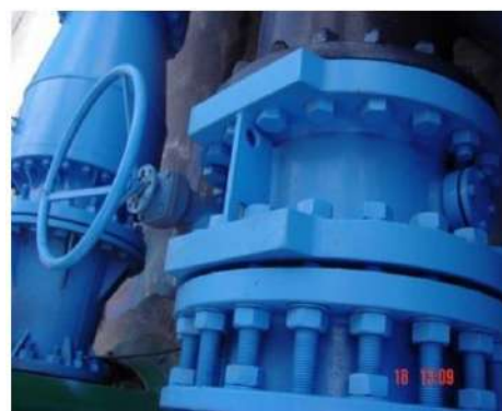
Figura N° 17 Válvula de Control
