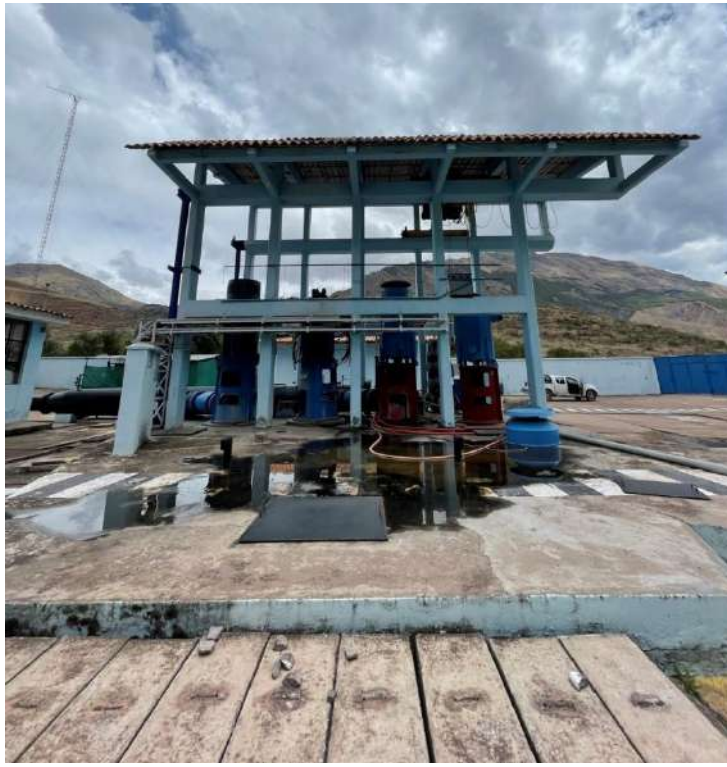
Foto N° 05: Estación de bombeo de Rumicolca
