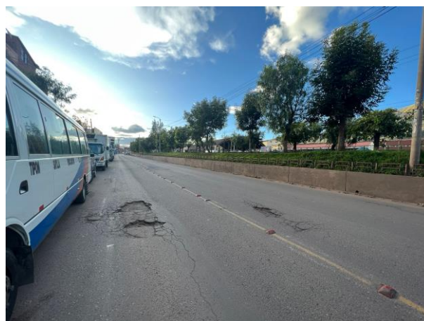
Figura N°02: Presencia de Baches en la Carpeta Asfáltica en la Prolongación Av. de la Cultura, San Jerónimo, Cusco.
