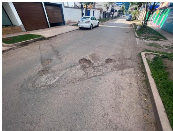
Figura N°01: Presencia de Baches en la Carpeta Asfáltica en Urbanización Cerveceros, Wanchaq, Cusco.
