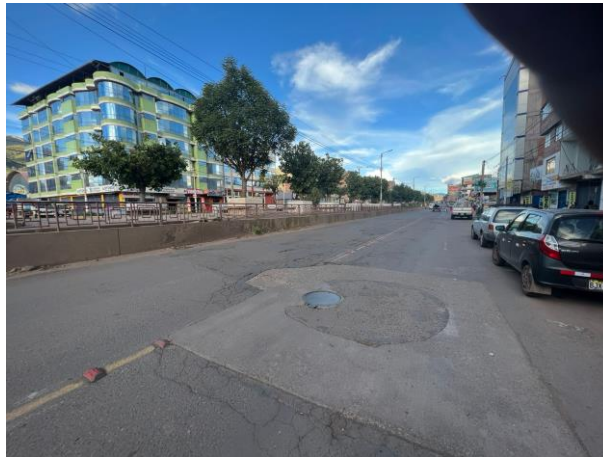
Figura N°03: Presencia Agrietamiento en la Carpeta Asfáltica en la Prolongación Av. de la Cultura, San Jerónimo, Cusco.
