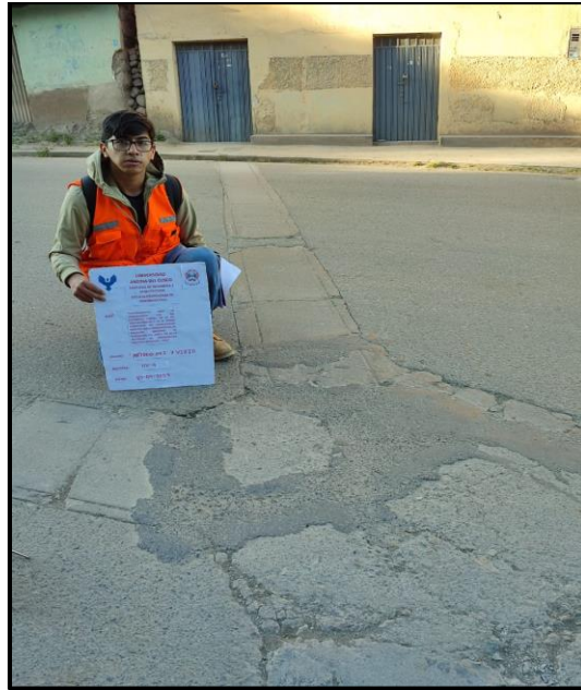
Figura 32 Identificación de la falla por parcheo
