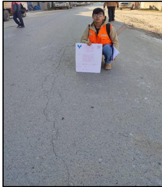
Figura 34 Identificación de la falla por fisura longitudinal
