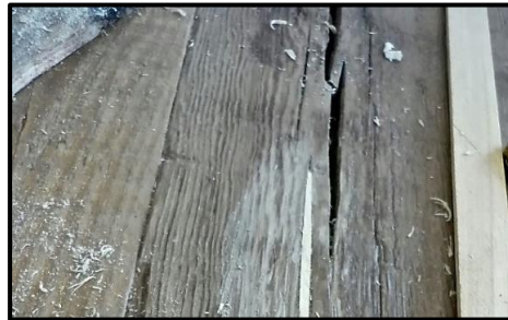
Figura N°22. Grieta de la madera.
