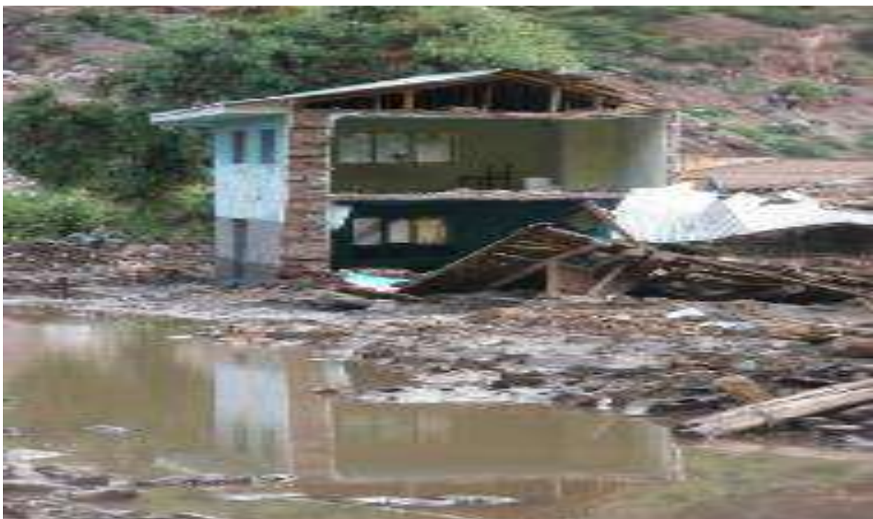
Figura 1: Daños en vivienda por inundación.
