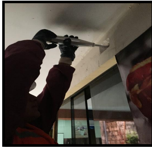
Figura 45: Toma de datos en elementos tipo columna – Estructura sin asistencia tecnica.
