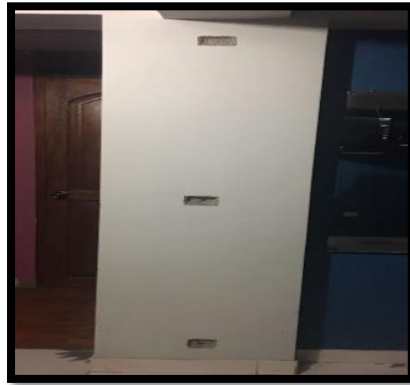
Figura 36: Vista frontal de elemento estructural tipo viga con picado para ensayo de esclerometría
