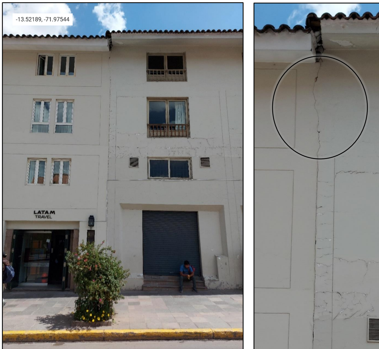
Figura 02: Edificaciones con visibles grietas en insuficientes juntas sísmicas.
