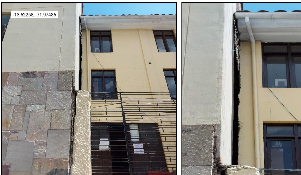
Figura 04: Edificaciones con visible espaciamiento para sus respectivos desplazamientos
