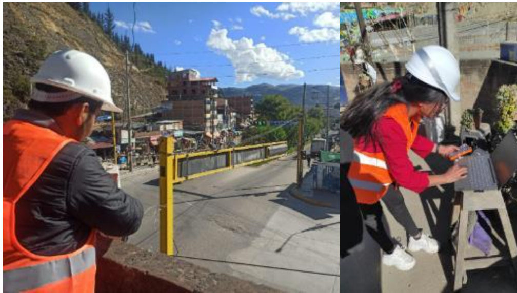
Figura 8: colocado y programado de las cámaras de seguridad
