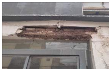
Desgaste en los muros laterales
