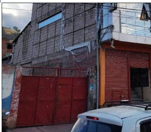
Contraste de la mampostería de ladrillo del cine con las bloquetas de los nuevos pisos
