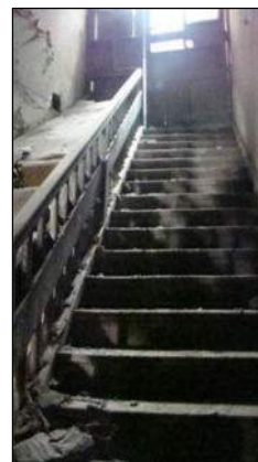
Escalera de escape
