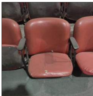
Estado actual de las butacas del mezanine
