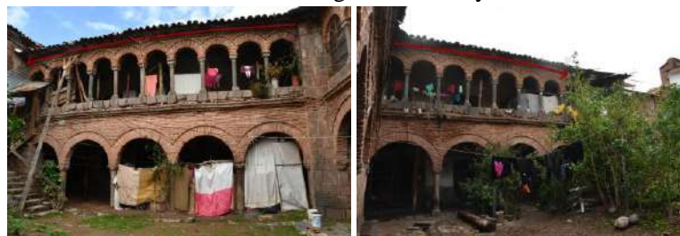
Asentamiento de galerías oeste y este.
