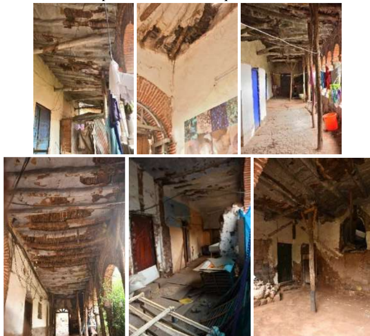
Desprendimiento de revoque de techo.
