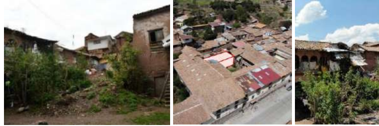
Crujía sur colapsada.
