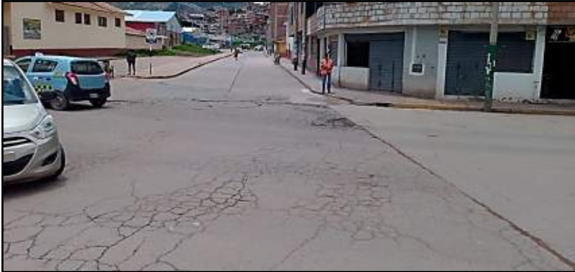
figura 3: Falta de señalización horizontal en cruces peatonales a la altura del hospital de contingencia en la intersección no semaforizada Avenida Agustín Gamarra – Avenida Alfonso Ugarte
