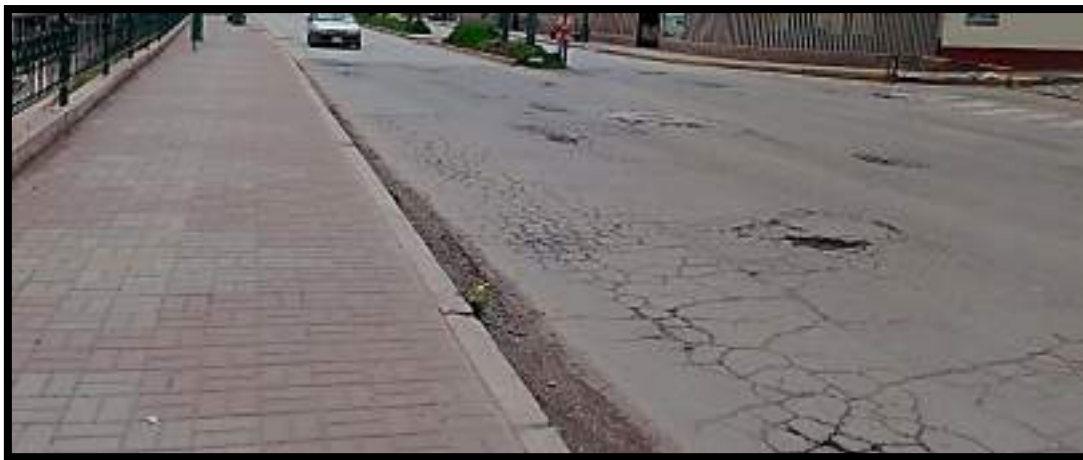
figura 4: Falla del tipo piel de cocodrilo, con nivel de severidad alta, en la intersección no semaforizada Avenida Agustín Gamarra – Avenida Alfonso Ugarte
