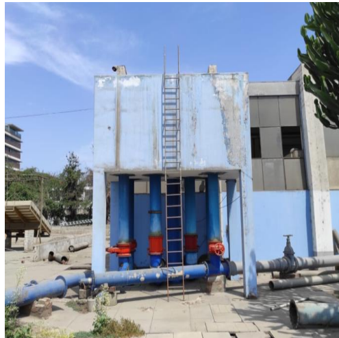
Fotografía 4: Tanque elevado y línea de impulsión
