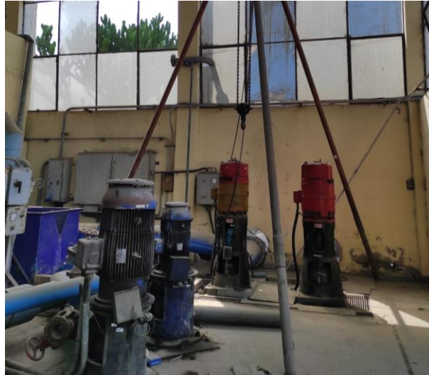
Fotografía 3: Bombas centrifuga de 50 hp y 30hp
