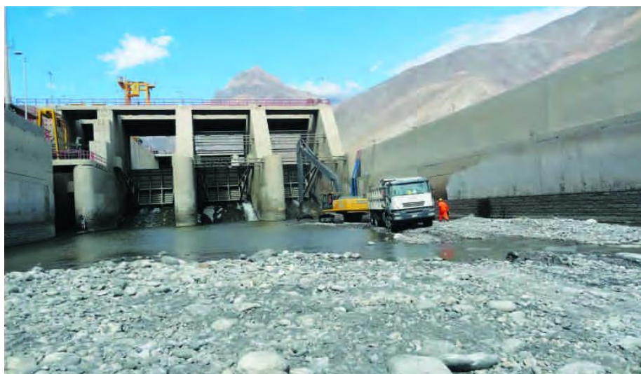
Figura 2: Erosión local aguas abajo de la Bocatoma Chavimochic
