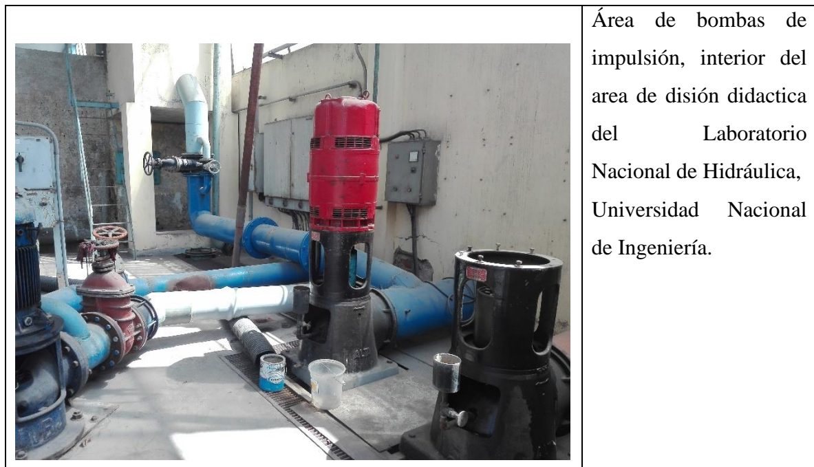
Figura 30: Condiciones iniciales de la línea de conducción
