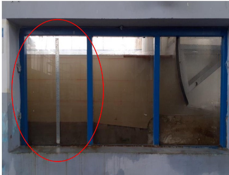
Fotografía 11: Regla metálica para medición de tirante aguas arriba
