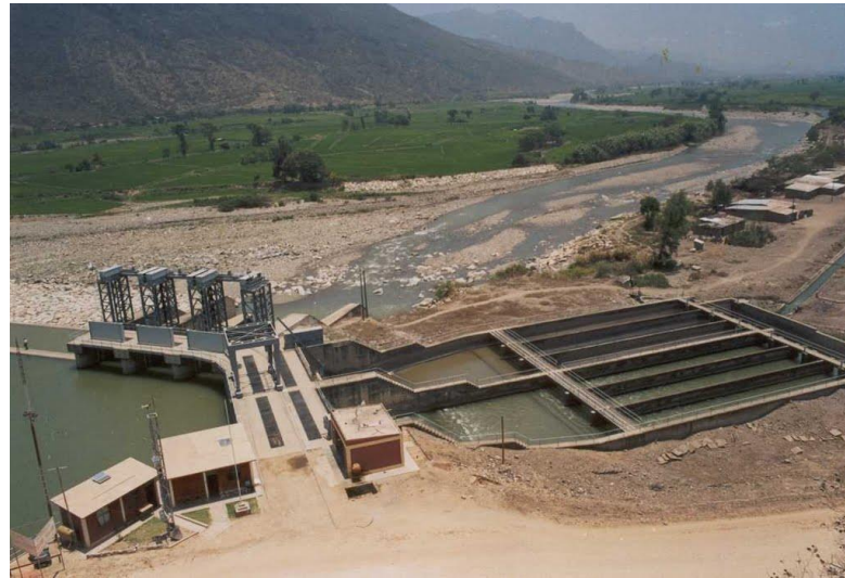
Figura 3: Erosión local aguas abajo de la Bocatoma Racarrumi
