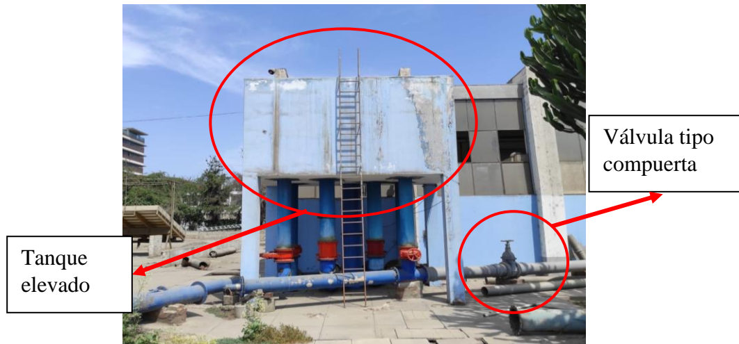
Fotografía 23: Tanque elevado y válvula de control.
