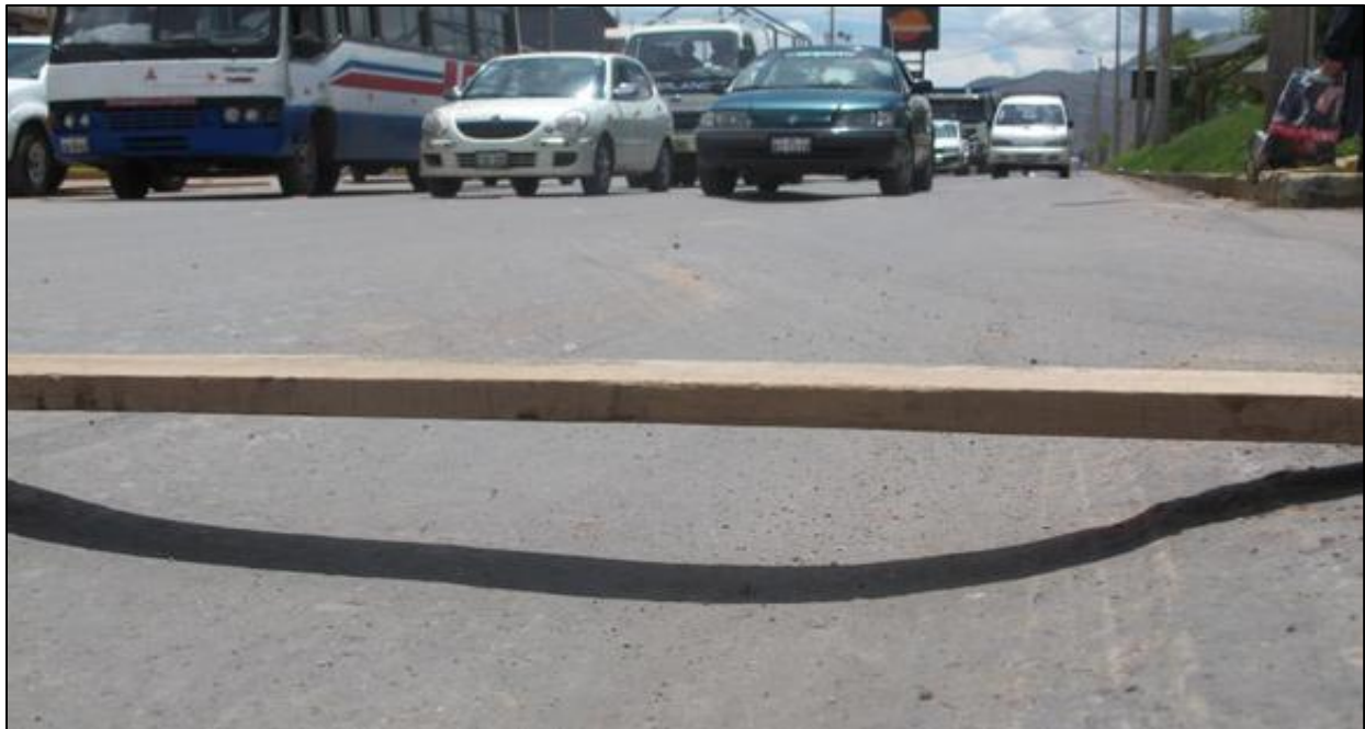
Figura 2 Problemas en la Infraestructura Vial Pavimentada, Av. de la Cultura: Ahuellamiento
