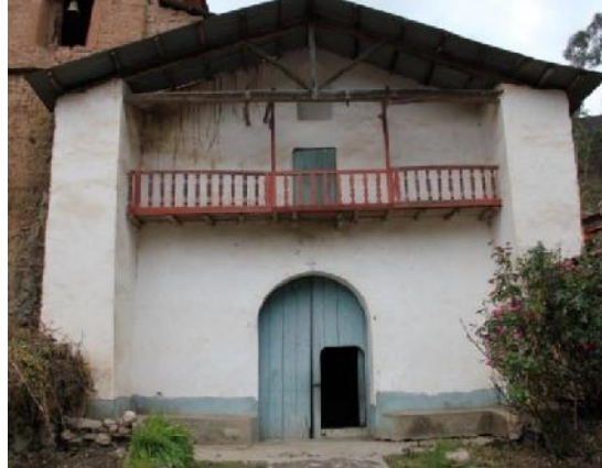
Fuente: expediente técnico "Puesta en valor del Monumento Colonial Religioso, templo San Cosme y San Damián de Lares"
