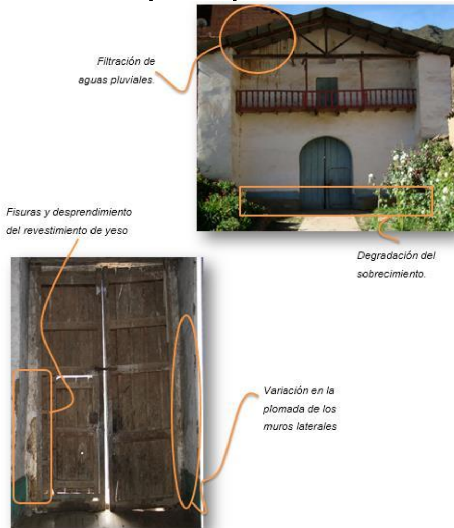
Figura 74 Patologías: muro de Pies
