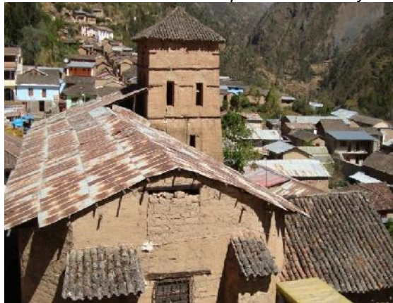
Figura 20 Techo deteriorado de calamina. Templo San Cosme y San Damián de Lares
