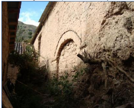
Figura 18 Muro del evangelio. Templo San Cosme y San Damián de Lares
