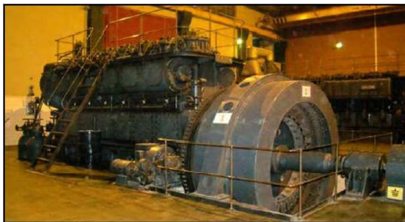
Ilustración 37: Grupo Electrógeno Sulzer, Subestación Dolorespata
