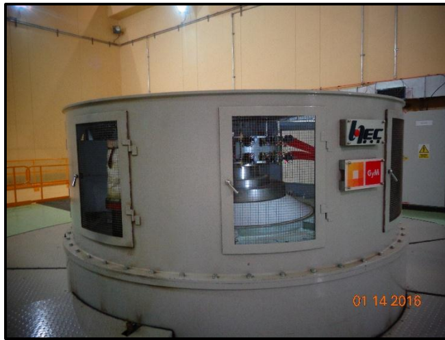
Ilustración 35: Sala de Máquinas Segunda Fase, Cabezal Grupo Francis
