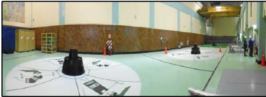
Ilustración 34: Sala de Máquinas Primera Fase, Vista de los tres Grupos Pelton
