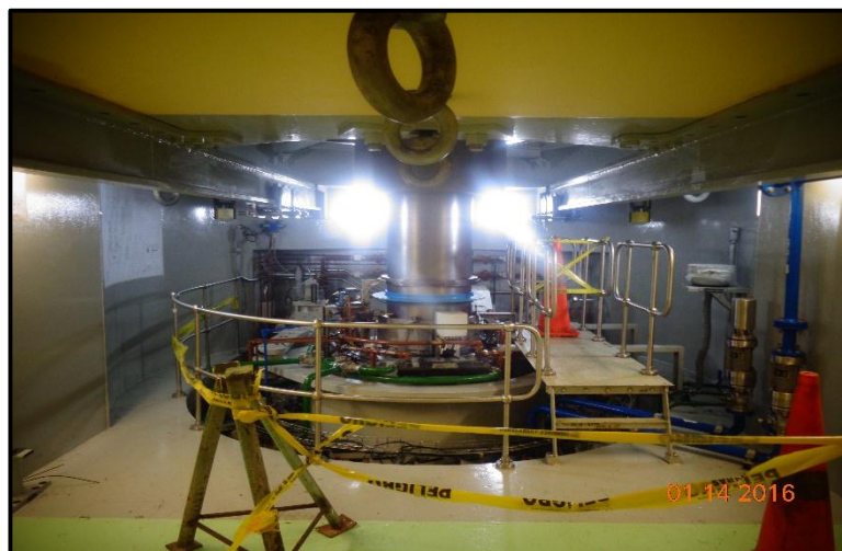
Ilustración 36: Grupo Francis, Sala de Máquinas
