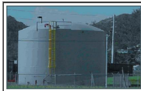
Figura 6. Tanque de acero para almacenar combustible
