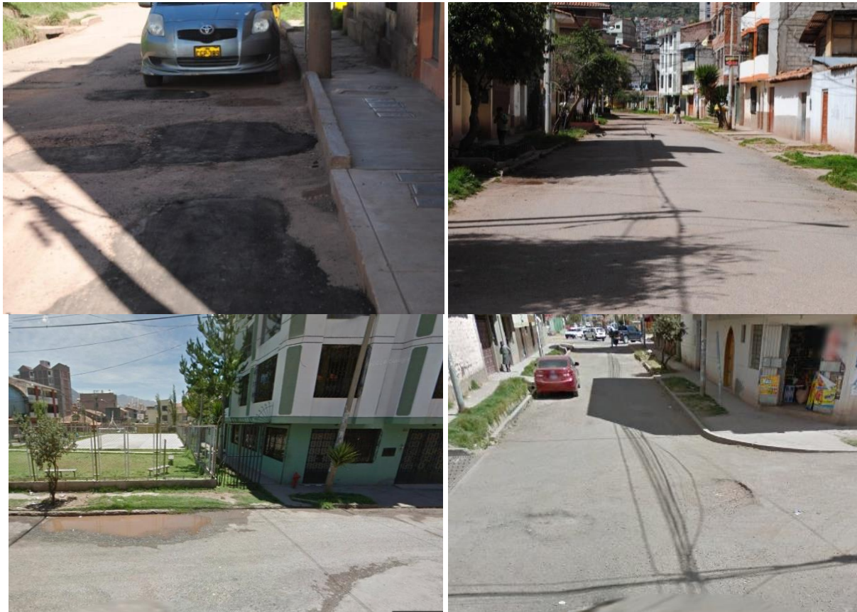
FIGURA N°1: Calles deterioradas de la Urb. San Judas Chico
