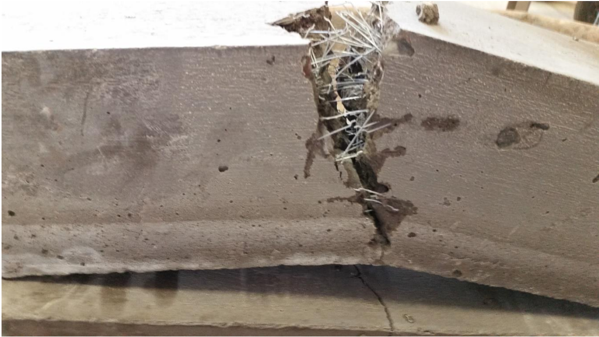
Fotografía 58: Falla a flexión concreto con Dramix 3D al 4%
