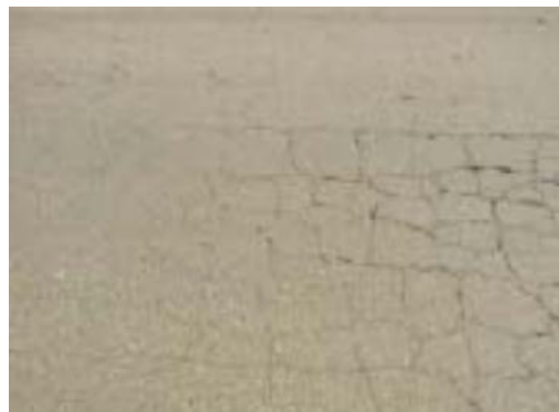
Figura 9: Pavimento con fisuras y grietas en bloque
