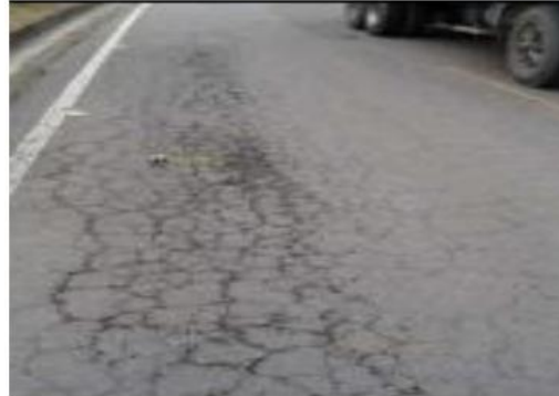
Figura 8: Pavimento con fisuras y grietas por fatigamiento
