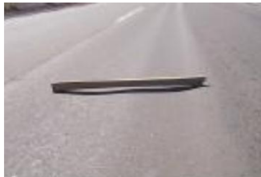
Figura 11: Pavimento con ahuellamiento
