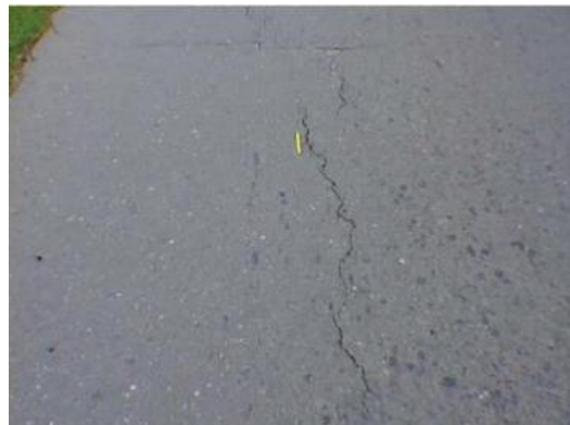
Figura 10: Pavimento con fisuras y grietas longitudinales y transversales
