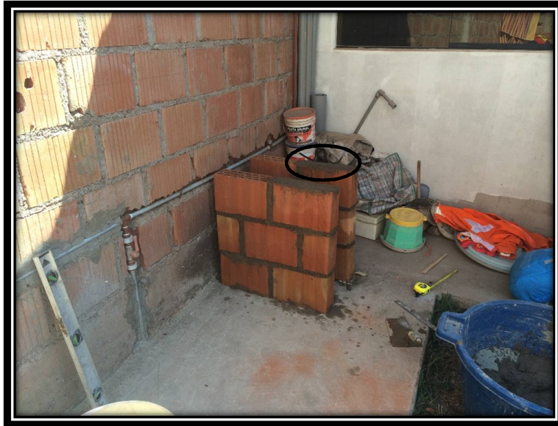
FOTOGRAFÍA N° 53: ELABORACIÓN DE MURETES CON LADRILO TIPO BLOCKER, SE LE COLOCÓ MORTERO PROPORCIÓN 1:3 EN VERTICES QUE ESTARA EN CONTACTO CON LAS ESCUDRAS
