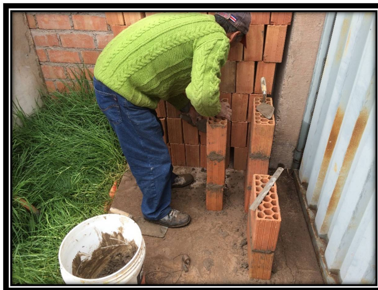
FOTOGRAFÍA N° 37: ASENTANDO LA UNIDAD DE ALBAÑILERIA EN LA TERCERA HILADA DE LAS PILAS
