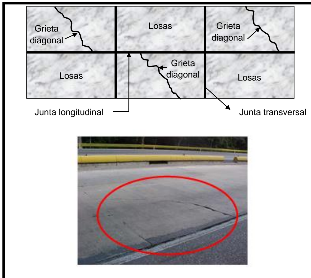
FIGURA N° 22 GRIETAS DIAGONALES EN LA CARPETA DE RODADURA DEL PAVIMENTO RÍGIDO
