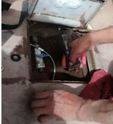
Figura N° 34: VERIFICACIÓN DE FUGAS EN CAJA DE REGISTRO.
