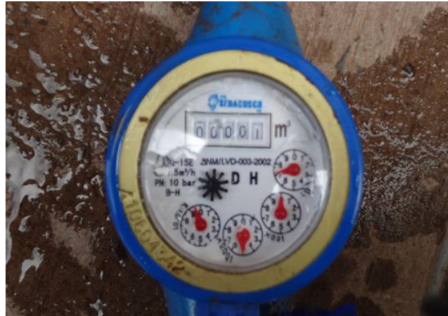
Figura N° 19: MEDIDOR DE AGUA POTABLE.
