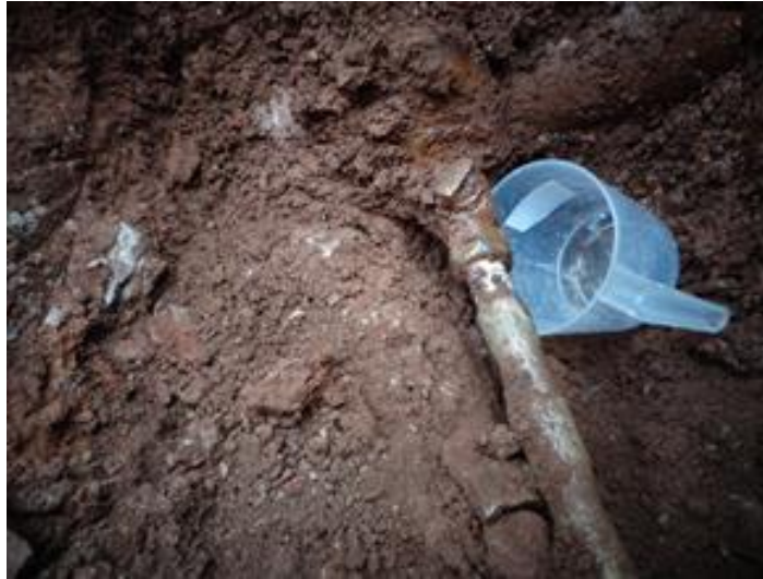
Figura N° 31: FUGA EN ABRAZADERAS, AFORADOR MIDIENDO EL VOLUMEN DE PERDIDA.
