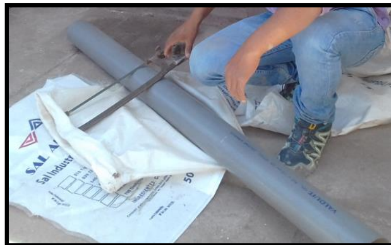
Figura 71. Tubería PVC de 4" de diámetro.
