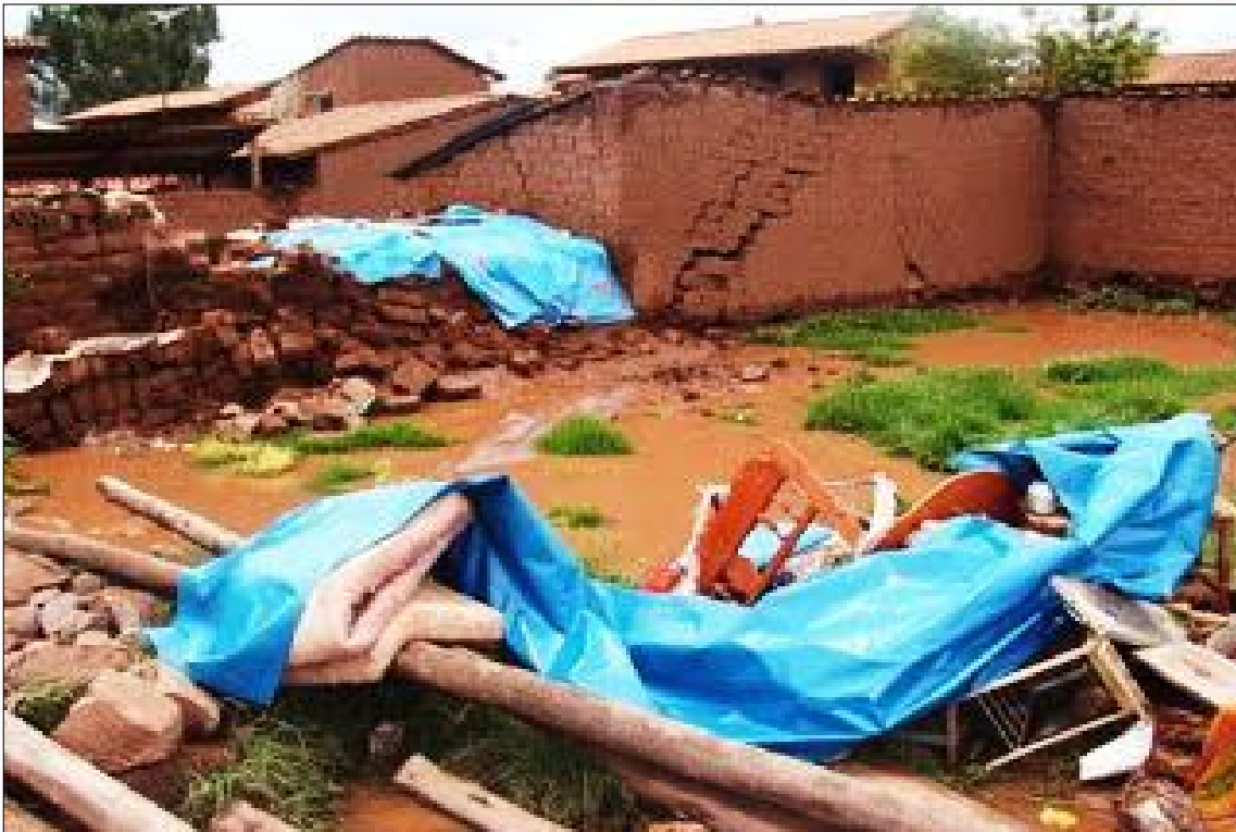
FIGURA N° 5 VIVIENDA DE ADOBE INUNDADA Y RAJADA POR DESBORDE DE RIO EN IZCUCHACA – ANTA.
