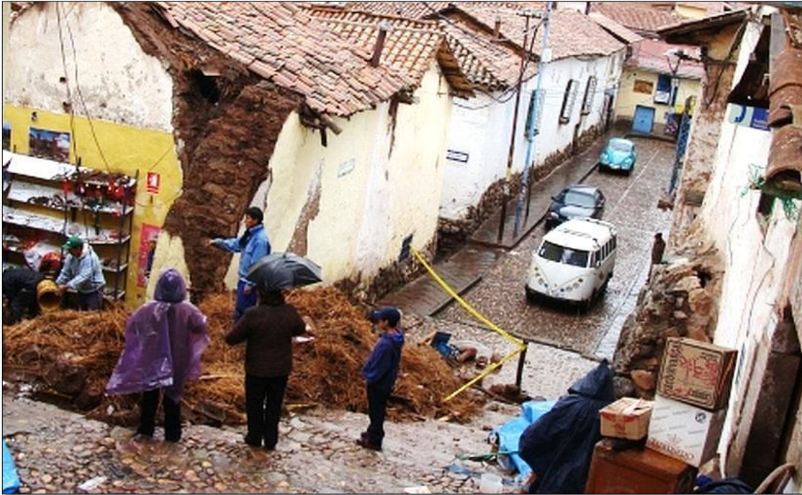
FIGURA N° 2 COLAPSO DE VIVIENDA DE ADOBE POR LLUVIAS EN SAN SEBASTIÁN.
