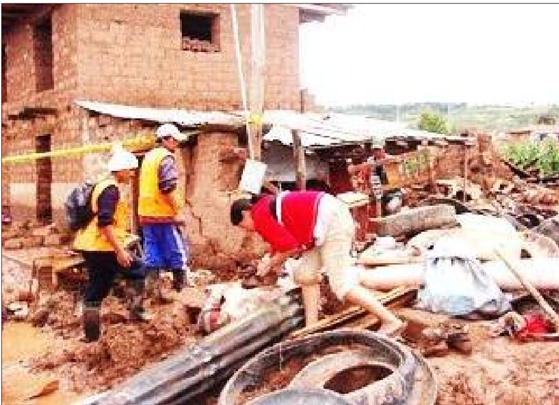
FIGURA N° 7 VIVIENDA DE ADOBE INUNDADA, RAJADA Y COLAPSADA POR DESBORDE DE RIO EN IZCUCHACA – ANTA.
