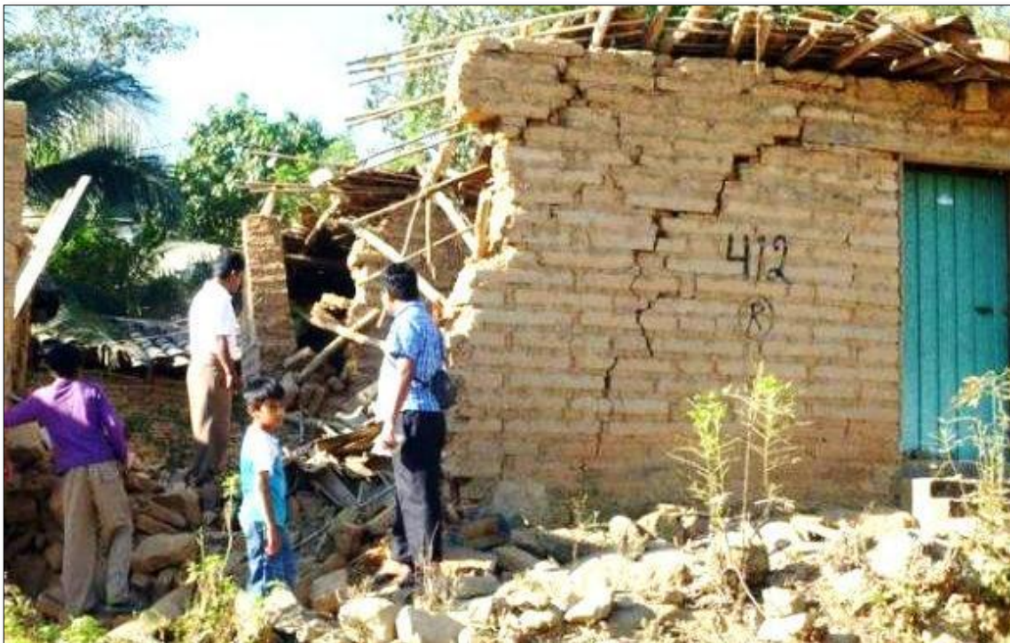
FIGURA N° 1 COLAPSO Y RAJADURA DE UNA VIVIENDA DE ADOBE.
