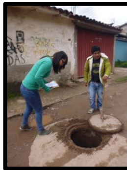
Figura N° 23: Verificación de diámetro de tuberías en los buzones dentro del Sistema de Aguas Residuales – APVs 28 de Julio, Kantu, Villa Mercedes y Vista Alegre
