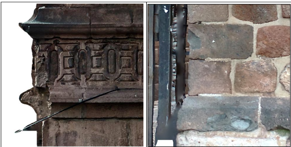
Figura 90: Fractura presente en la primera cornisa de la torre de Evangelio
