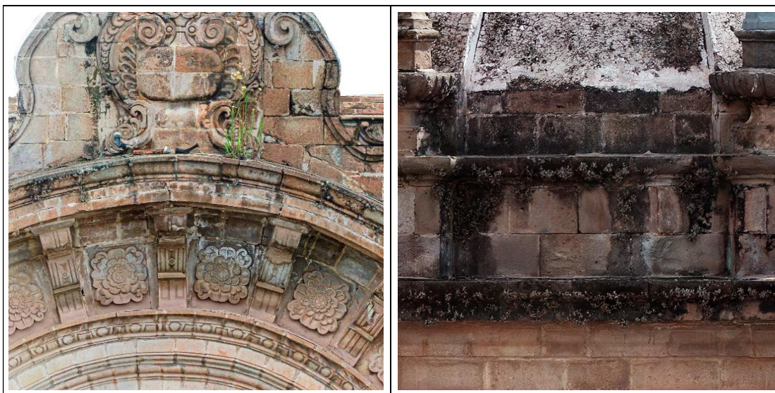
Figura 108: Humedad de Filtración en la coronación y base de la cúpula del campanario de la Epístola.
