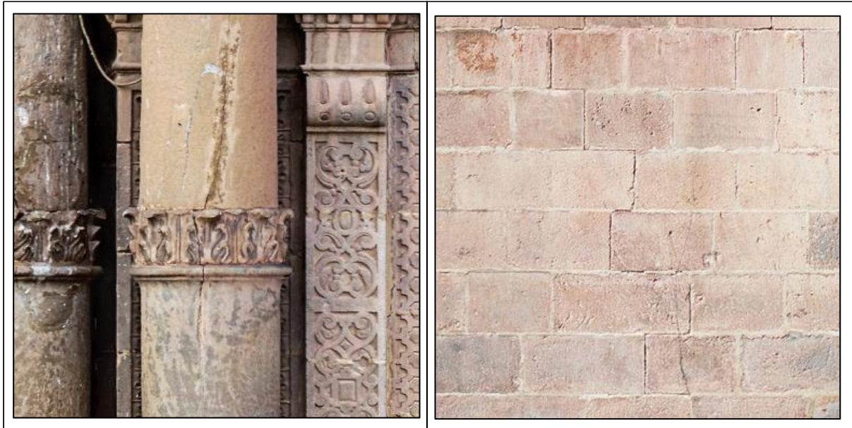
Figura 87: Fisuras en el imafronte del Templo de la Compañía de Jesús.
