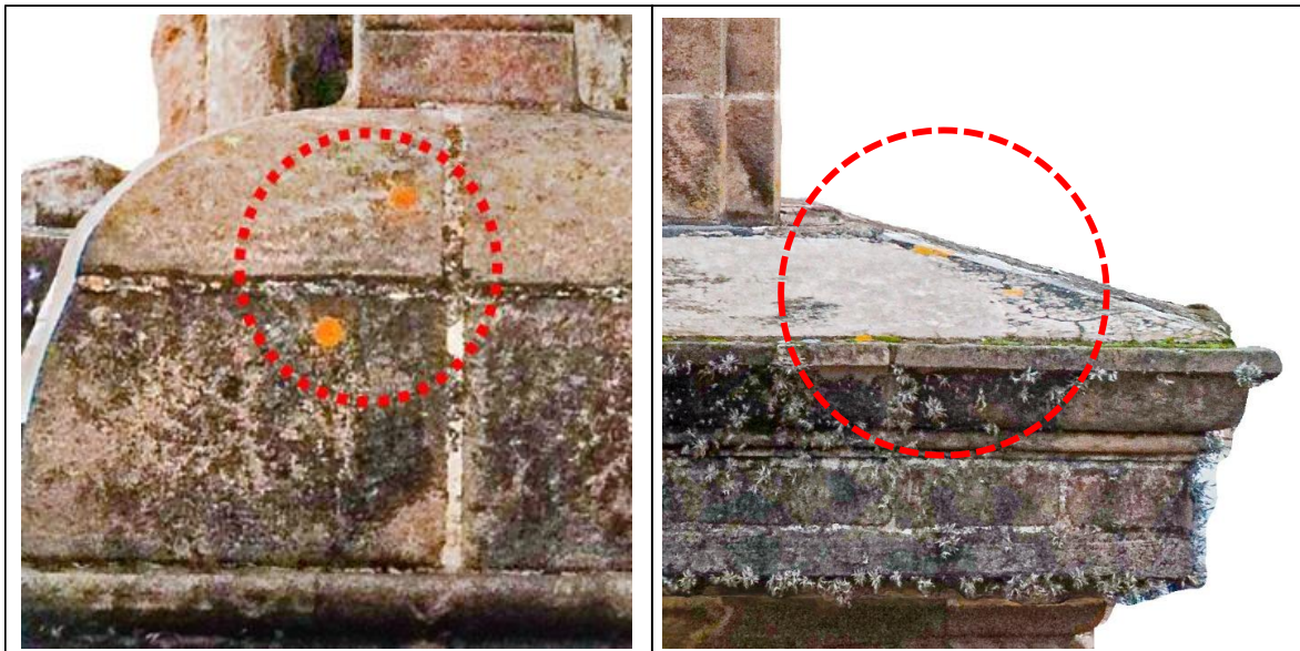
Figura 93: Liquen presente en los pináculos y cornisas del Imafronte.
