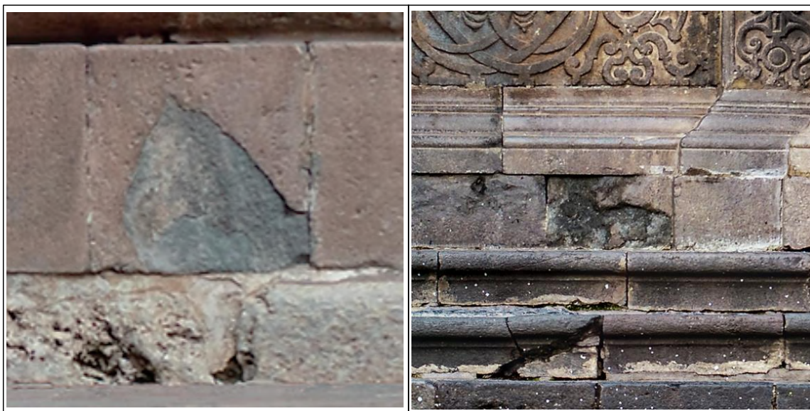
Figura 102: Descamación presente en el lateral de la Torre del Evangelio y en el basamento del Imafrente
