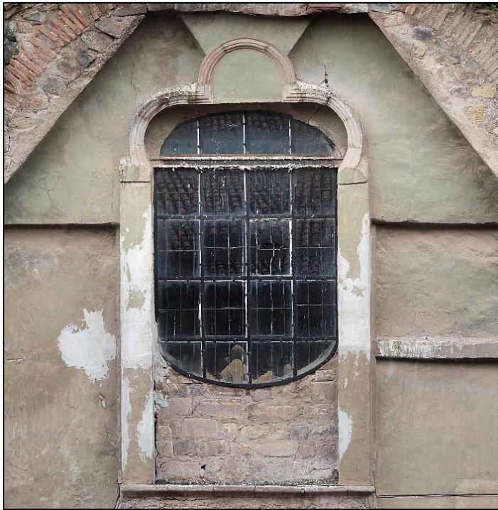
Figura 70: Detalle del vano en ojo de buey y el frontón trilobulado en el alzado Norte del Templo.
