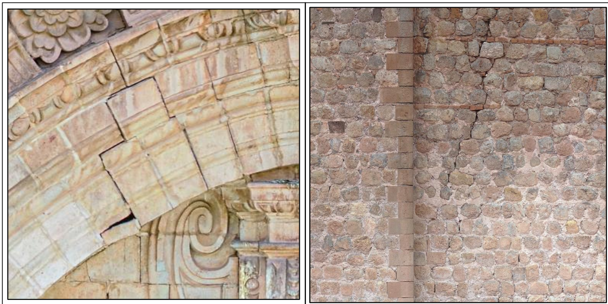
Figura 88: Grietas en la coronación del Imafronte; grietas en el alzado de la calle Loreto.
