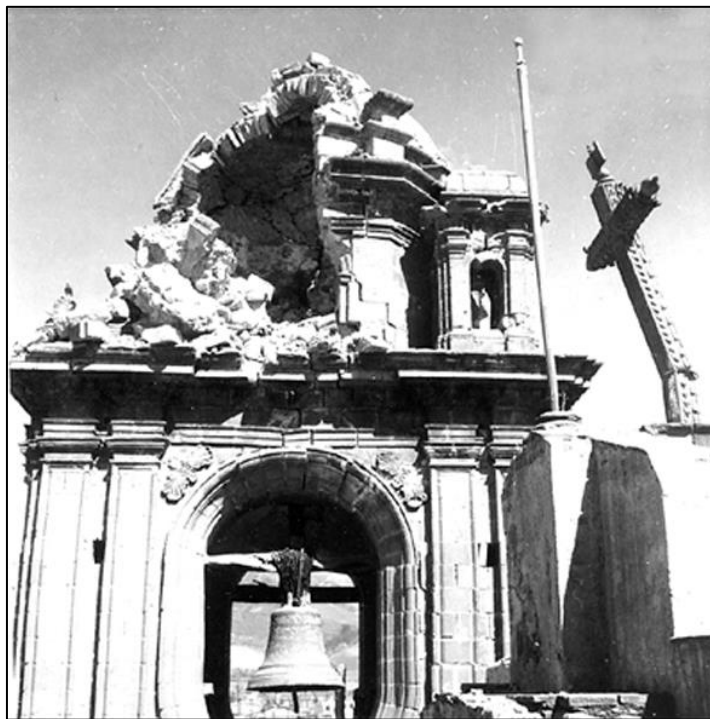
Figura 40: Desplome de la cúpula de campanario de la Epístola en el terremoto de 1950
