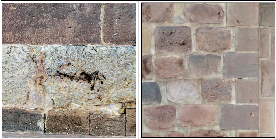
Figura 96: Alveolización en el lateral de la torre del Evangelio.
