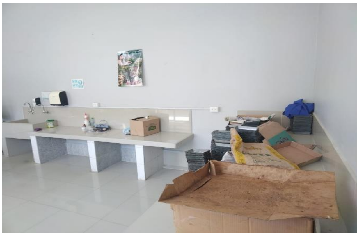
Áreas de trabajo sin limpieza y en desorden
