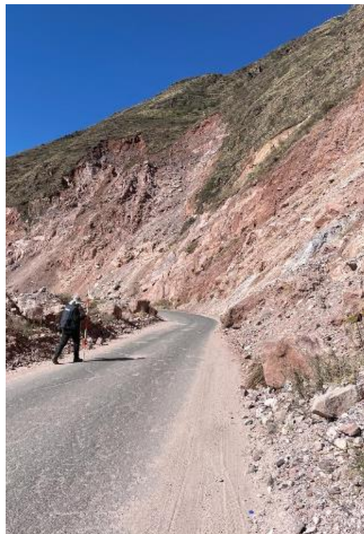
Situación de carretera: Deslizamientos
