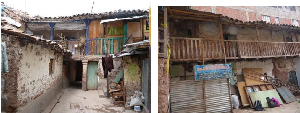
Figura N° 68, 69: Inmuebles con valor patrimonial en mal estado de conservación, Trinitarias, Calle Nueva (2018). Fuente: Archivo propio.
