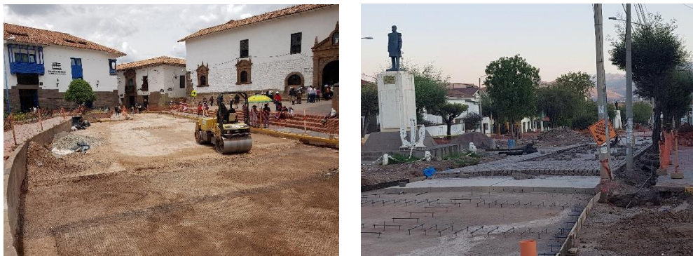
Figura N° 75, 76: Compactado, sellado de calles, Santo Domingo, Paseo de los Héroes (2021, 2022). Fuente: Archivo propio.
