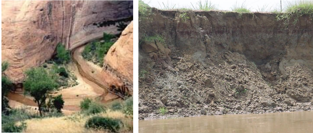
Figura 16. Erosión de margen de ríos
