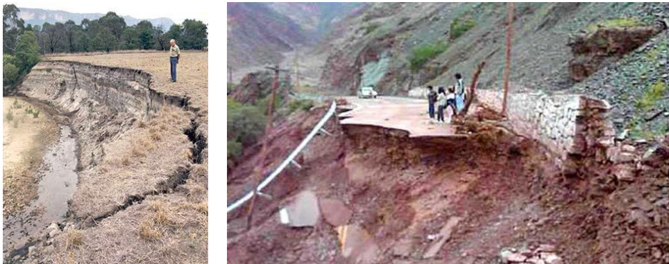
Figura 15. Manifestaciones de erosión por movimientos en masa
