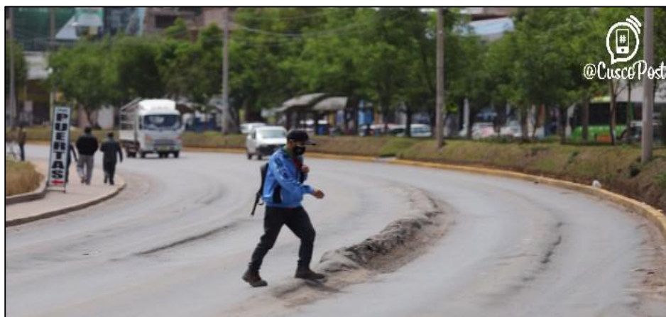
Estado del pavimento flexible de la Avenida la Cultura
