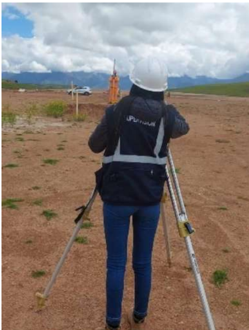
Figura 164 Monitoreo placa de asentamiento Sector T4-AR-2
