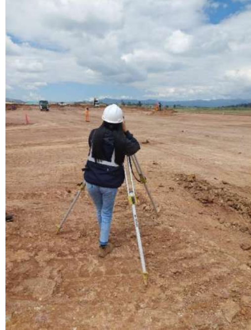
Figura 152 Monitoreo placa de asentamiento Sector S2-1
