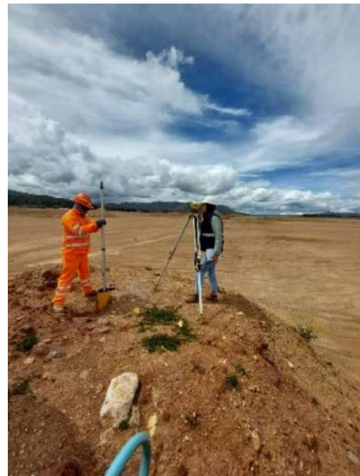
Figura 150 Monitoreo placa de asentamiento Sector S3-1
