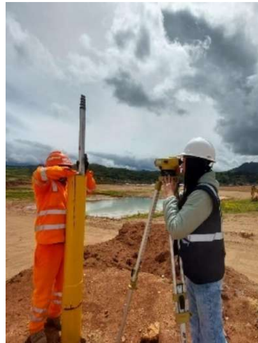
Figura 175 Monitoreo placa de asentamiento Sector T4-AR-3
