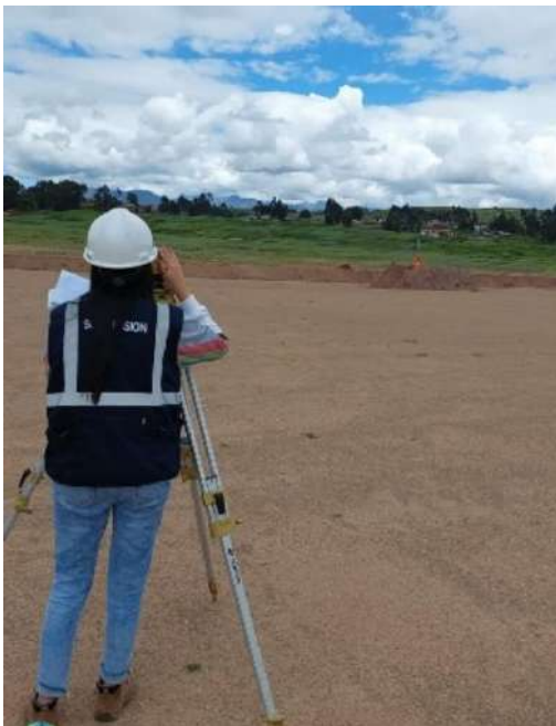
Figura 160 Monitoreo placa de asentamiento Sector T6-SEI-1
