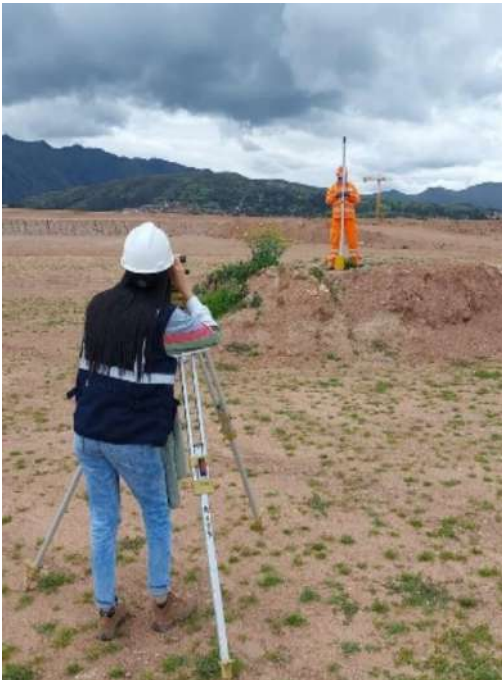
Figura 149 Monitoreo placa de asentamiento Sector S2-2
