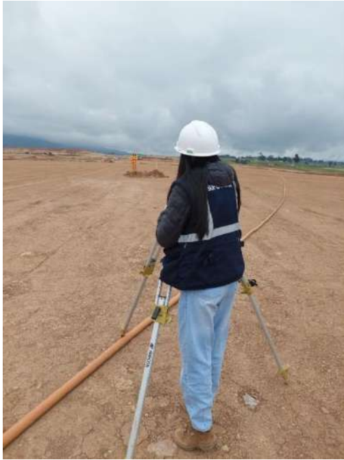
Figura 154 Monitoreo placa de asentamiento Sector S3-2
