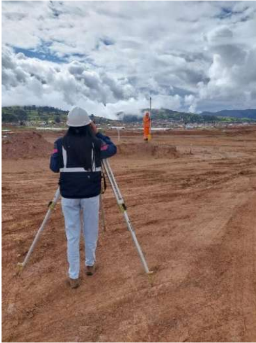
Figura 178 Monitoreo placa de asentamiento Sector T4-AR-4
