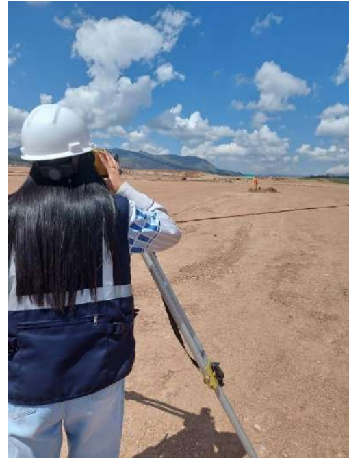
Figura 144 Monitoreo placa de asentamiento Sector S1-2
