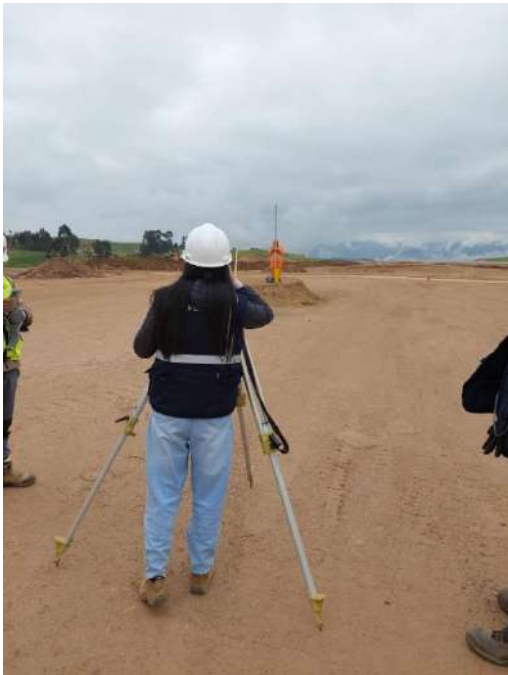
Figura 143 Monitoreo placa de asentamiento Sector S1-1
