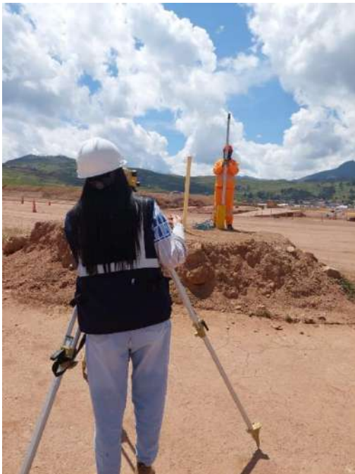
Figura 142 Monitoreo placa de asentamiento Sector S1-3
