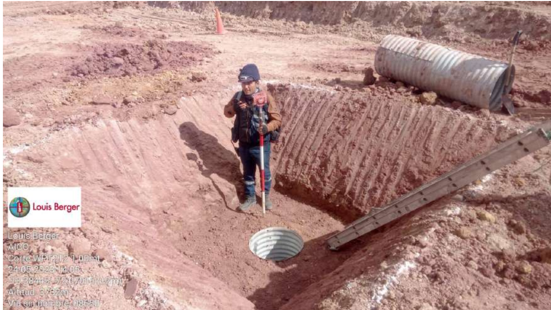
Figura 13 Water point- pozo de bombeo
