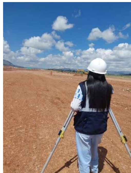
Figura 141 Monitoreo placa de asentamiento Sector S1-4
