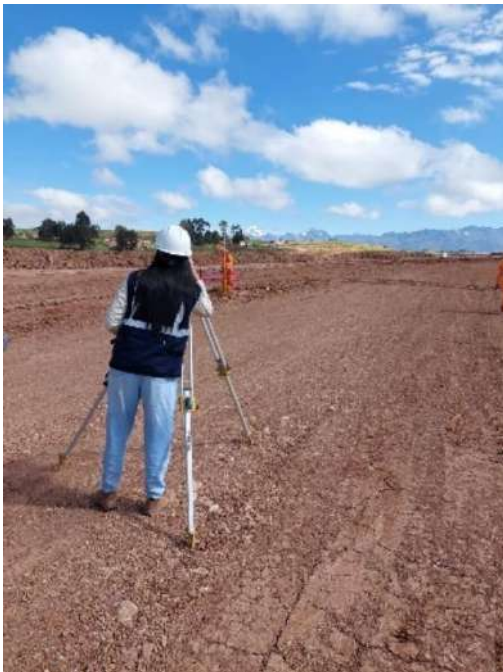
Figura 182 Monitoreo placa de asentamiento Sector T4-SEI-3
