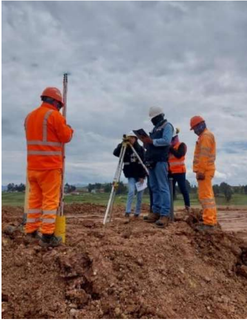
Figura 170 Monitoreo placa de asentamiento Sector T4-AR-1
