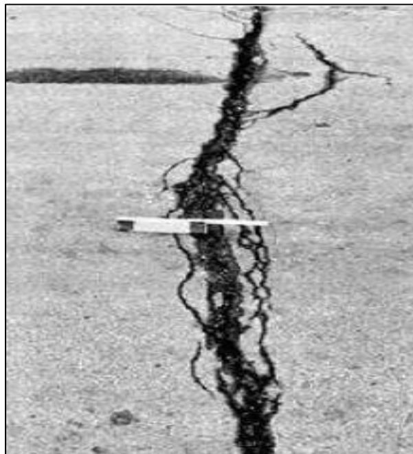
Fisura de Reflexión de Junta-Alta Severidad
