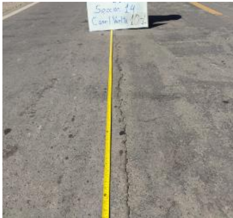
Grieta Longitudinal y Transversal- Alta Severidad
