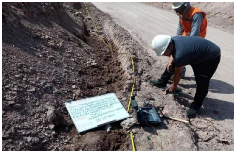
Figura 42: Cambio de estación en el pie del talud
