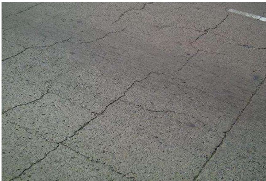
Figura 1. Fisuración por retracción por secado
