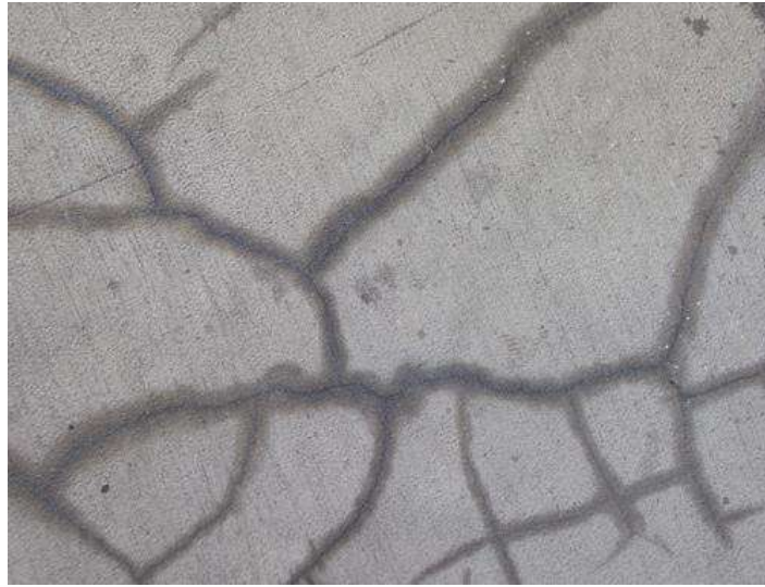
Figura 2. Fisuración por retracción plástica
