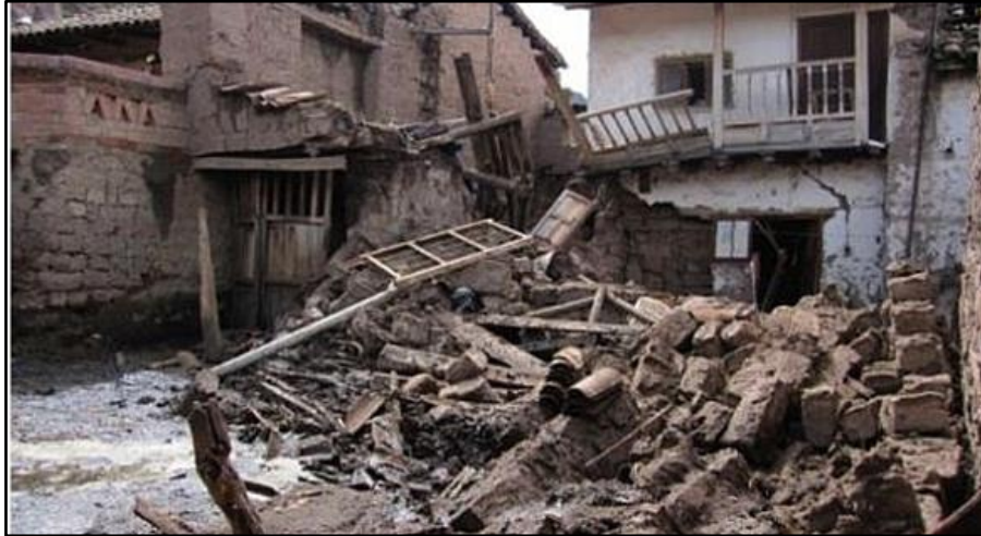
Figura 2: Vivienda Sometida a Exposición Prolongada de Agua
