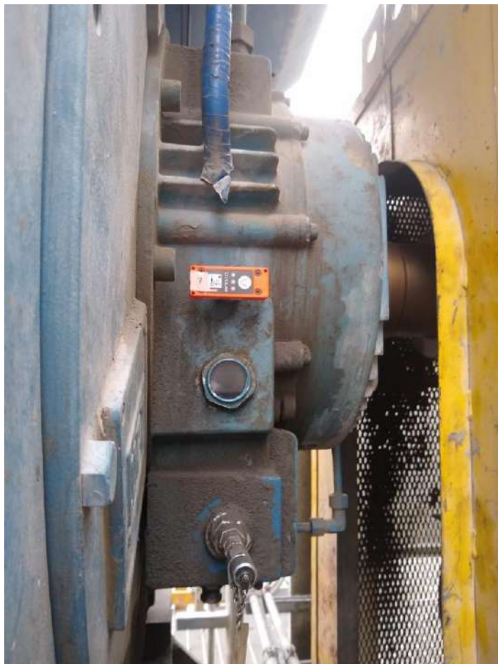
Figura 13: Instalación de sensores OMA
