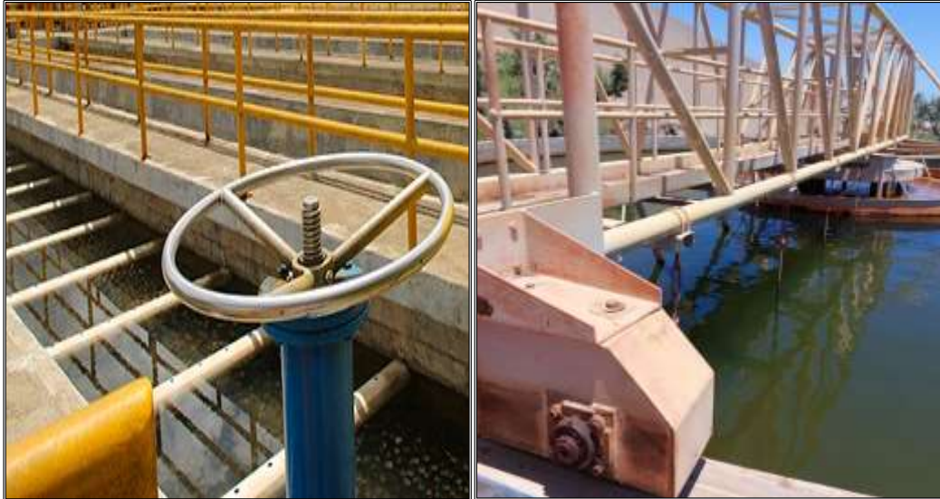
Figura N° 27. Instalaciones PTAP – I Cata Catas Fuente: Elaboración propia
