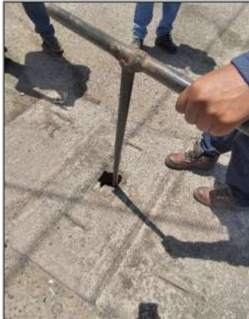
Figura N° 40. Cierre de Válvula de frontera Fuente: Elaboración propia
