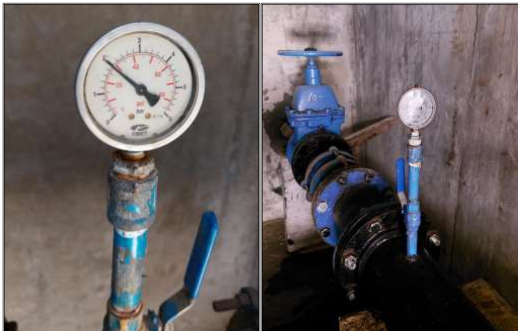
Figura N° 35. Lectura de presión mediante manómetro instalado en cámaras de monitoreo
