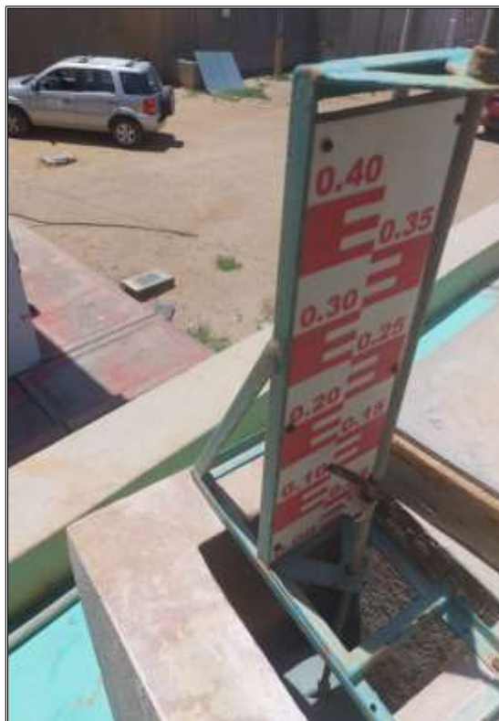
Medidor Tipo Parshall PTAP II – Pampa Inalámbrica
