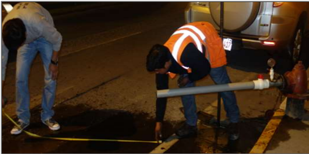
Figura N° 34. Lectura de presión mediante manómetro conectado a hidrante
