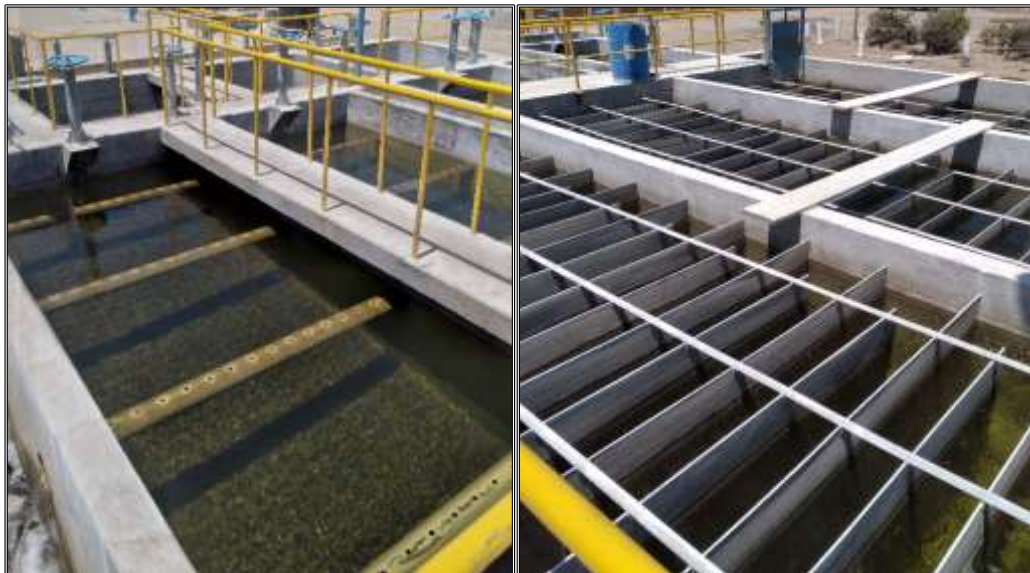
Figura N° 28. Instalaciones PTAP – II Pampa Inalámbrica Fuente: Elaboración propia
