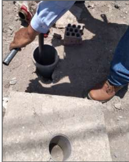
Figura N° 43. Apertura de válvula Fuente: Elaboración propia
