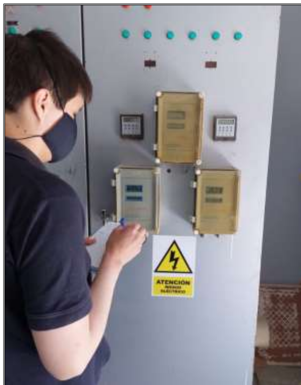
Figura N° 23. Tablero de lectura de macro medidor electromagnético (PTAP I Cata Catas)
