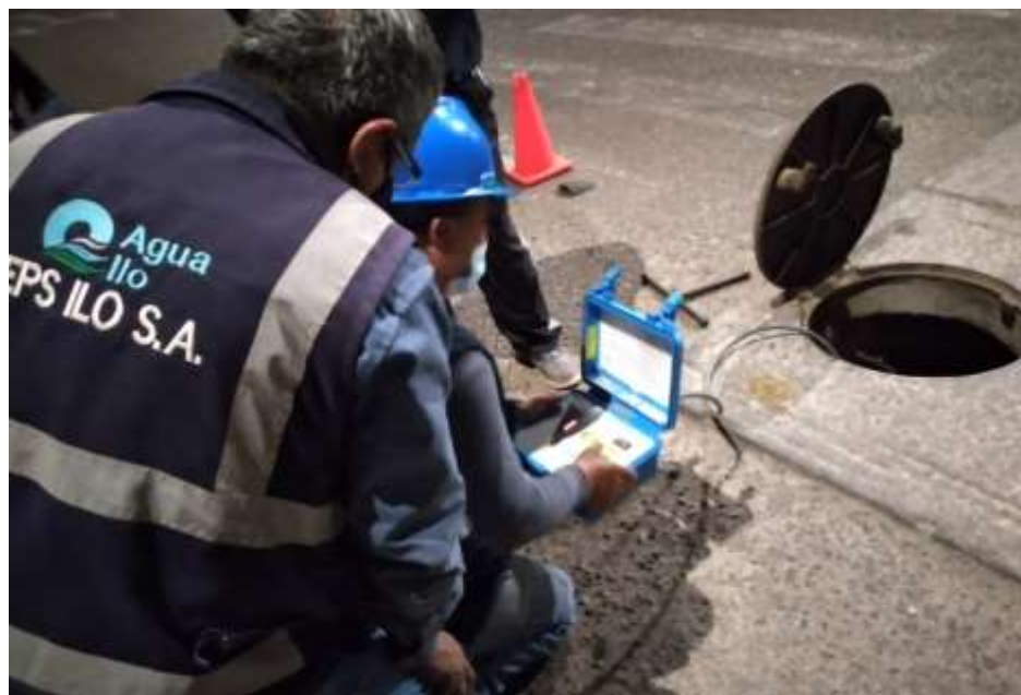
Figura N° 50. Programación de Caudalímetro en la tubería de ingreso. Fuente: Elaboración propia
