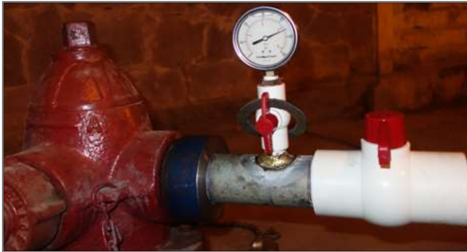
Figura N° 29. Manómetro conectado al hidrante mediante tubería de 2'' y válvulas globo
