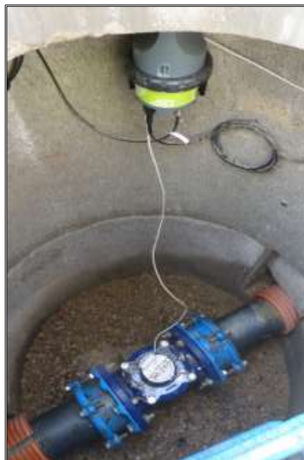
Figura N° 57. Instalación de Data Logger - Sub Zona 2B-3. Fuente: Elaboración propia
