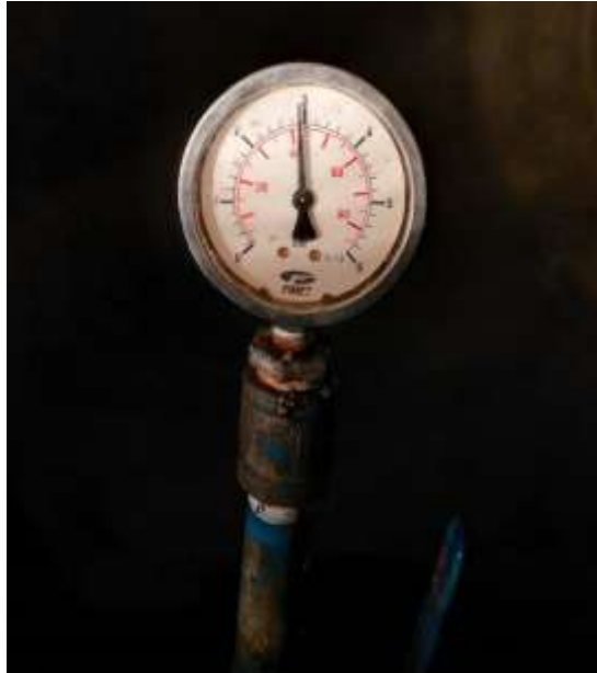
Figura N° 55. Manómetro – Cámara de Monitoreo – Sub Zona 6F-1 Urb. Las Glorietas.
