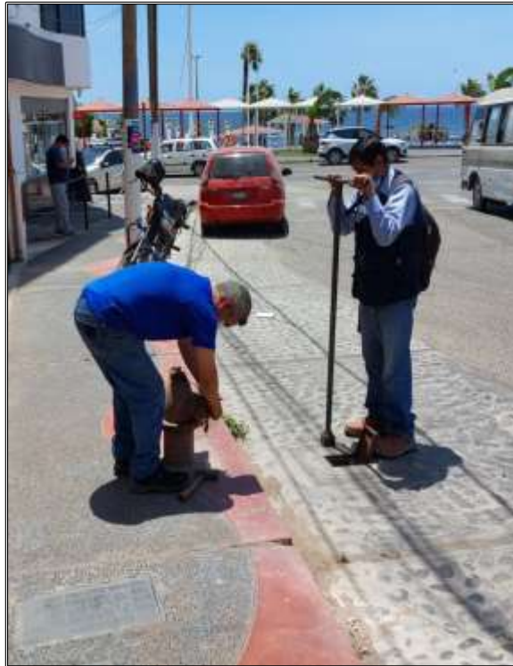
Figura N° 30. Apertura de hidrante con llave Tee Fuente: Elaboración propia
