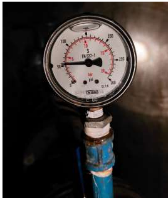
Figura N° 54. Manómetro – Cámara de Monitoreo – Sub Zona 2B-3 Urb. San Pedro. Fuente: Elaboración propia
