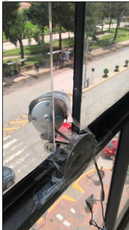
Figura N°60. Cámara Filmadora instalada
