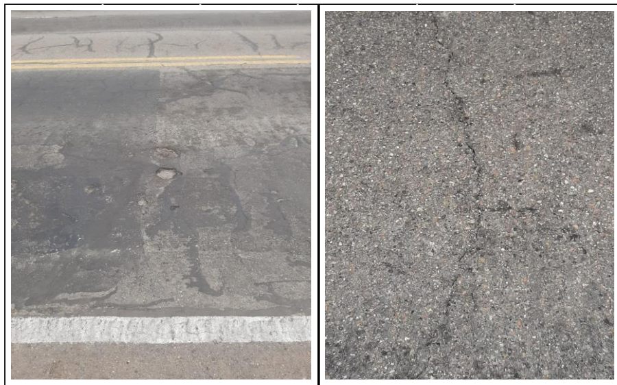
Figura 93: Defectos encontrados en calzada (huecos, peladuras, desprendimientos y fisuras) en el sector 8A Costanera.
