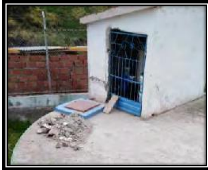
FIGURA N° 124 TAPA SANITARIA EN RESERVORIO
