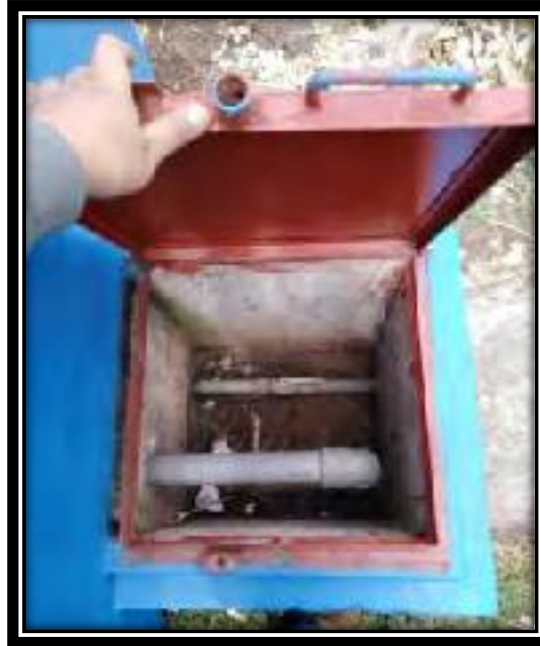
FIGURA N° 115 CAJA DE VALVULAS EN CAMARA DE RUNION
