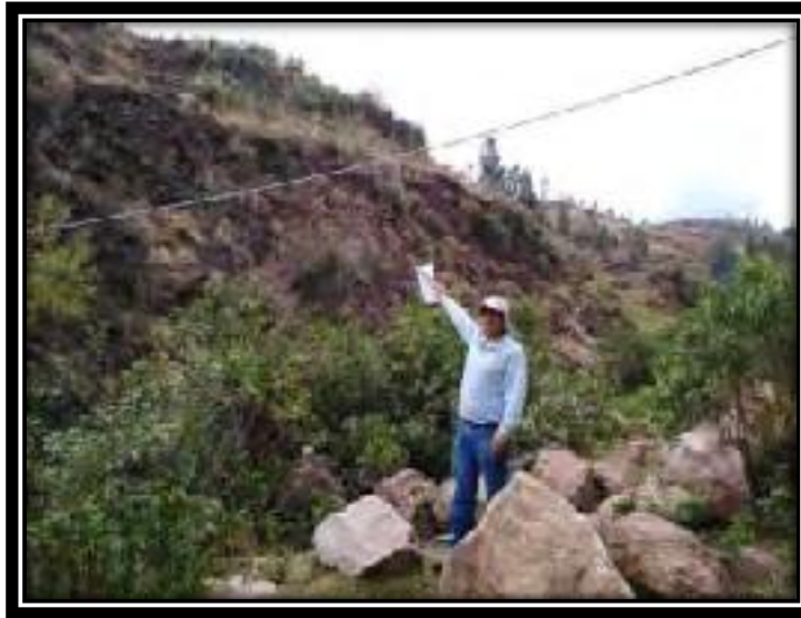
FIGURA N° 134 PASE AÉREO EN LÍNEA DE DISTRIBUCIÓN
