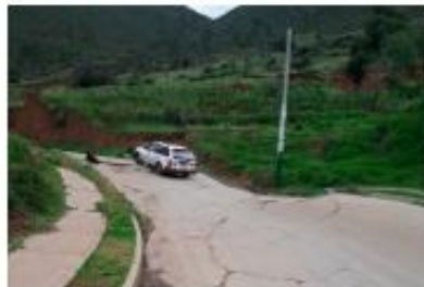
ILUSTRACIÓN 1. MUESTRA DAÑOS EN LA CARRETERA.
