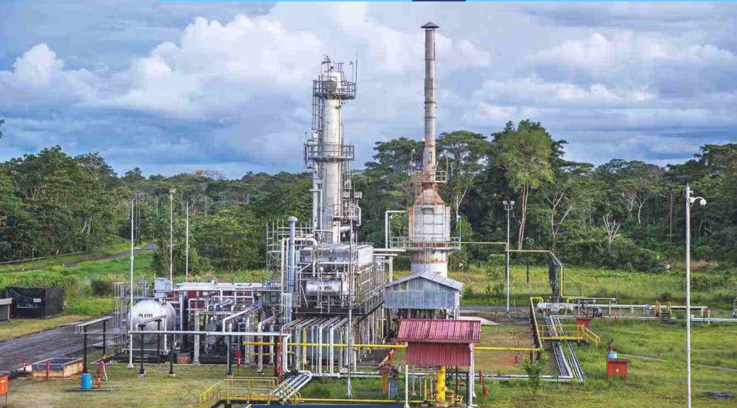
Topping Plant, Lote 8. Foto GFHL-Osinergmin.
