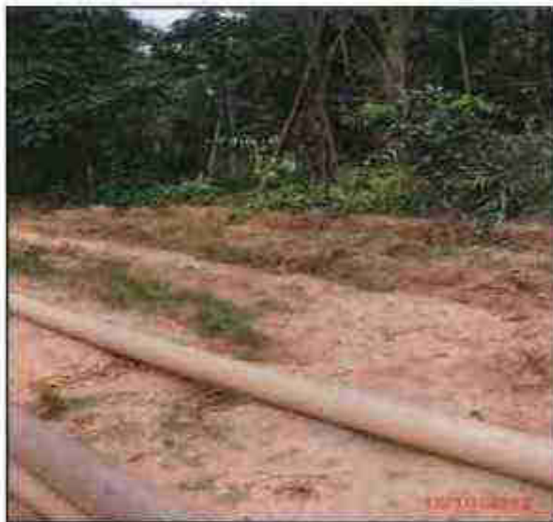
Fotografía N° 27 del Informe N° 219880-2012-GFHL-UPPD: Con esta vista se puede observar la cercanía de las tuberías en mal estado junto al inicio de la quebrada Shanshocochoa.
