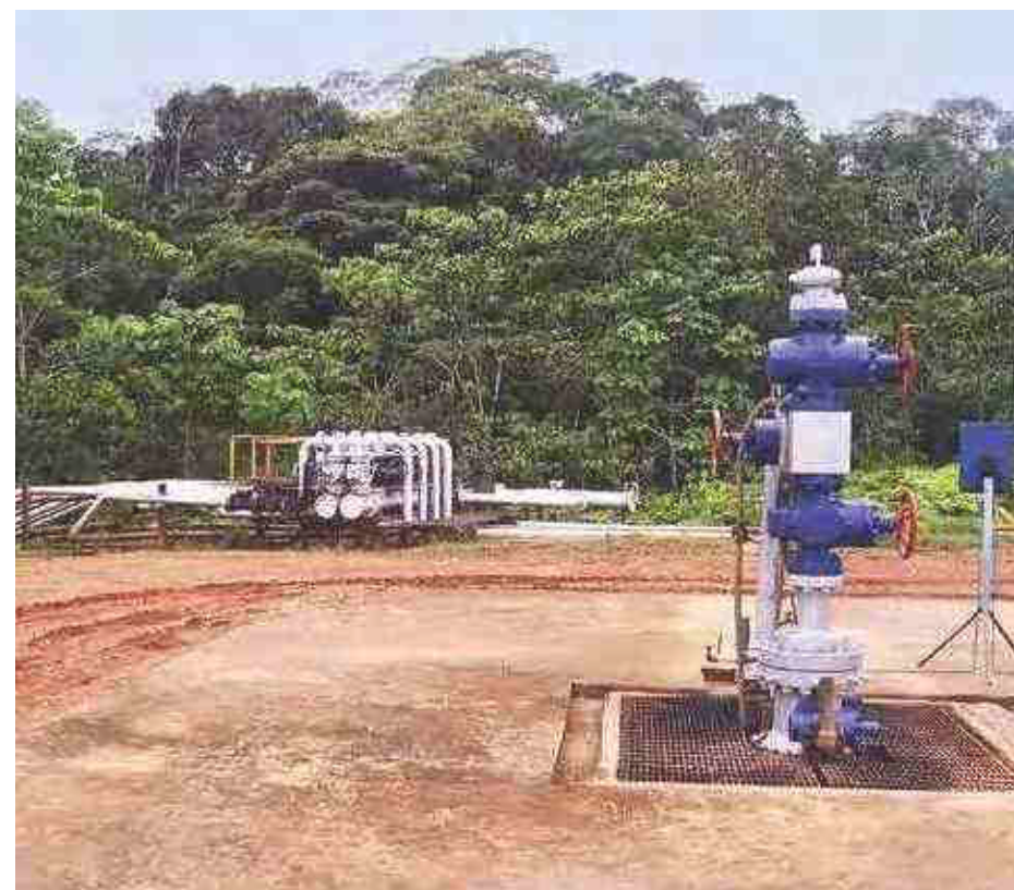
Múltiple de distribución forestal (Selva). Foto GFHL-Osinergmin.
