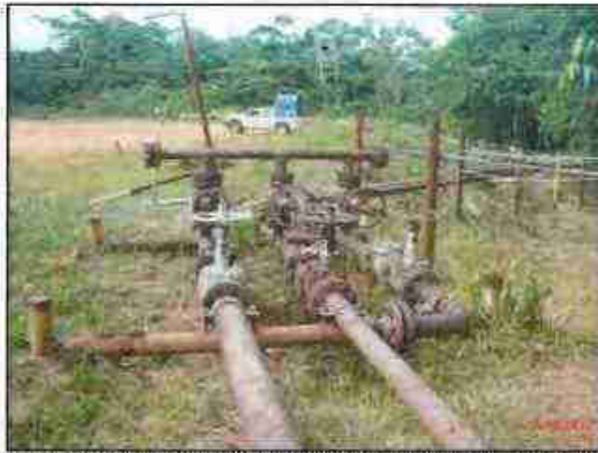
Fotografía N° 20 del Informe N° 219880-2012-GEHL-UPPD: Manifold a donde están conectadas las líneas de flujo de los pozos, sin protección contra la corrosión.
