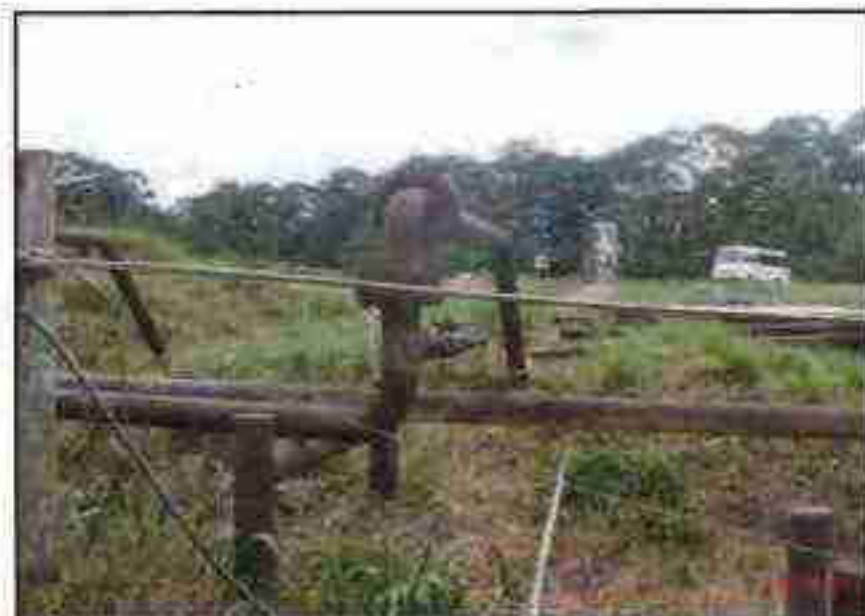
Fotografía N° 18 del Informe N° 219880-2012-GFHL-UPPD: Tuberías; línea de flujo que sale del Pozo CS18 y de inyección que entra al pozo reinyector.
