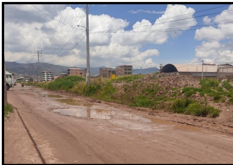
Figura 2. Deterioro de la Vía Expresa del Cusco.
