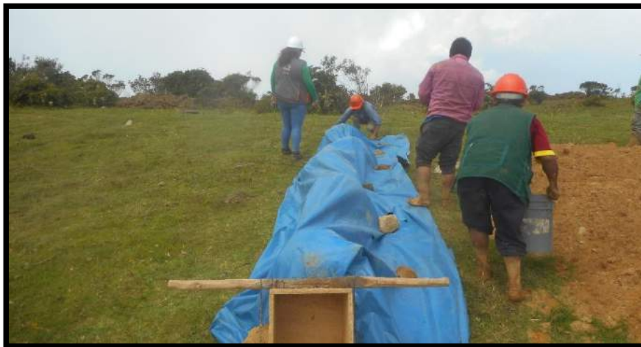
Figura 38: Protección de las rumas de mezcla luego del amasado inicial Fuente: Propia
