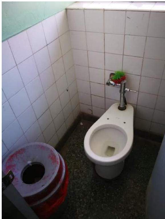
Figura 29 Recipiente para residuos en los baños del Hospital Regional.
