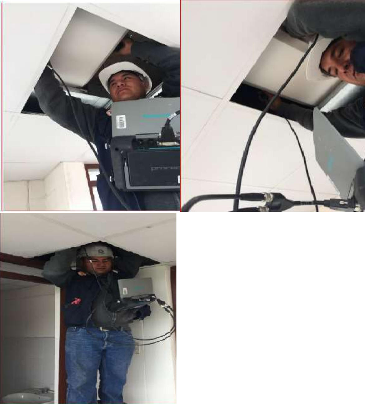
Figura 52 - Ensayo Ultra sonido- resistencia a la compresión Pundit PL interior-externo en vigas del Tercer nivel de la tribuna Occidente de los anillos del estadio Inca Garcilaso de la Vega.
